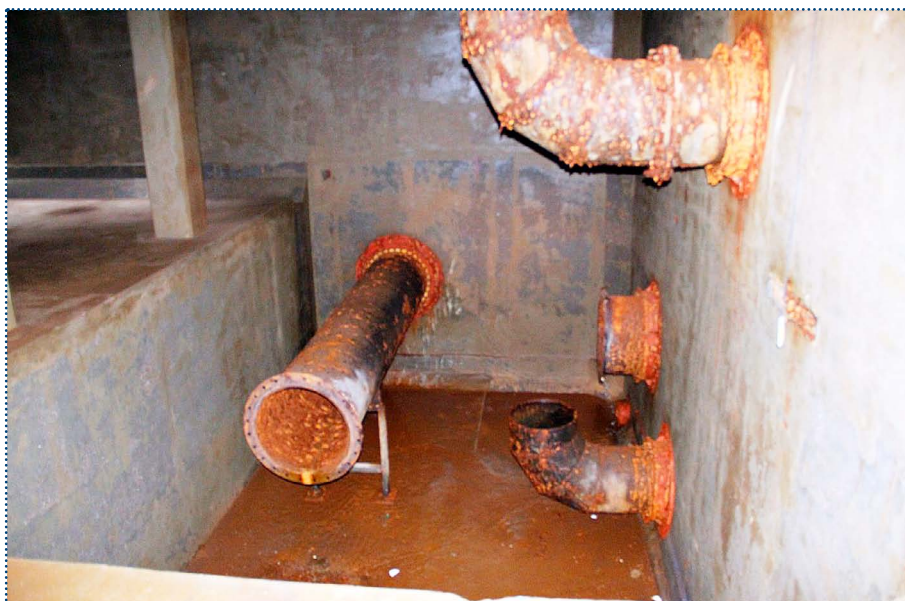
Fot. 2. Znaczna korozja metalowych instalacji rurowych w odnawianym zbiorniku [1]
